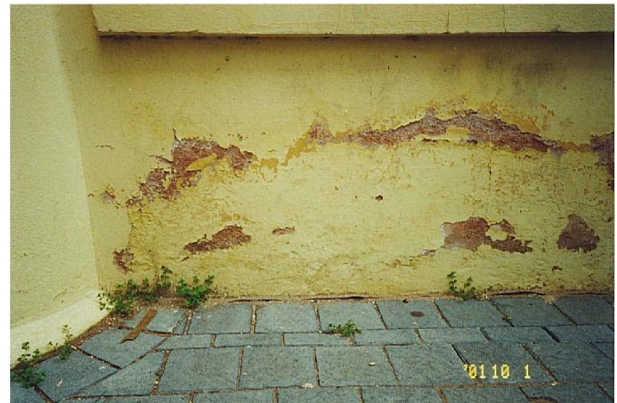
写真 13 塩害による塗装剥げ
