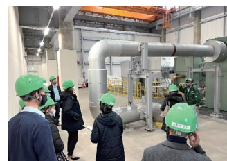
セツ島バイオマス発電所視察の様子
