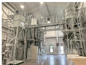
DASSAI BLUE が醸される蔵内設備の一部 提供：DASSAI USA INC.
