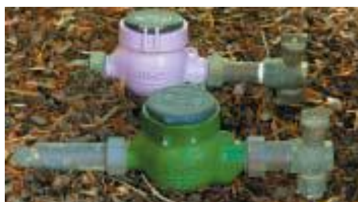
水道メーターは水道水用とリサイクル水用がそれぞれ備え付けられている
