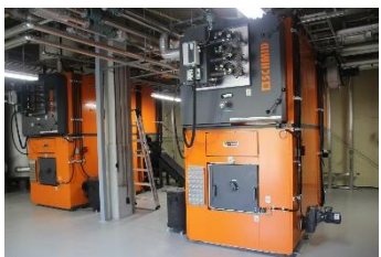
Chaudière biomasse à bois
